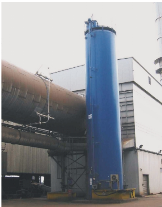
5 Gesamtansicht der HOK-Dosiereinrichtung Overall view of the HOK dosing system
